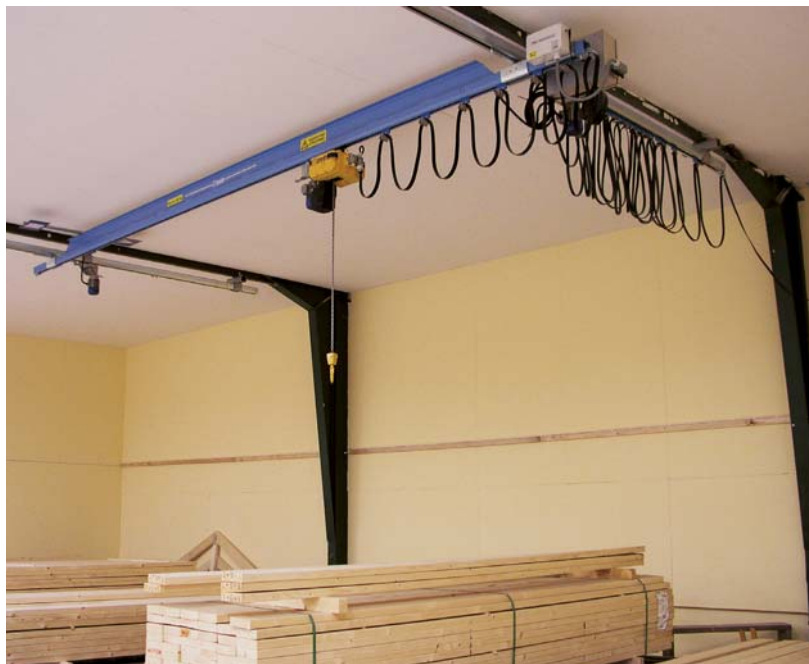
PMH Lättprofiltravers utrustad med PMH Classic elektrisk kättingtelfer samt med eldrivning på alla åkrörelser, styrning sker via PMH Radiostyrning.
